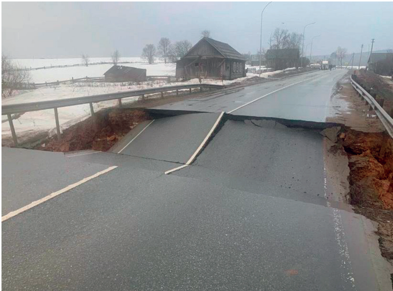
Рис. 2. Просадка покрытия ввиду деформации уплотнения грунтов
