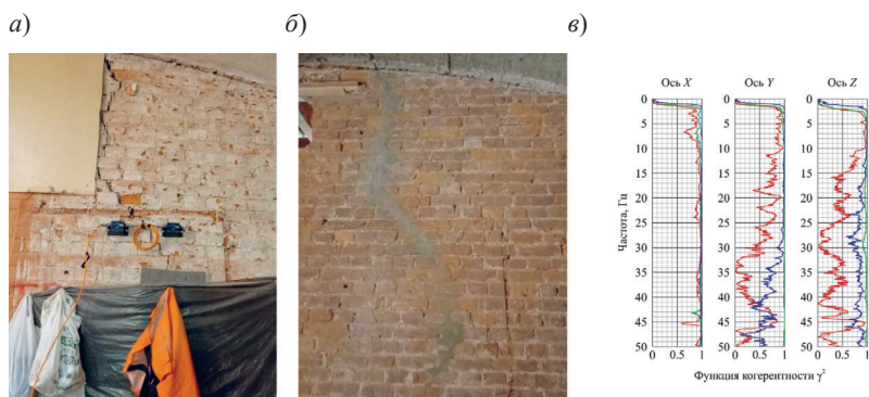
Рис. 4. Результаты оценки качества проведенных работ по инъектированию трещины: a – вид трещины до усиления; б – вид трещины после усиления; в – результаты обработки измерений
